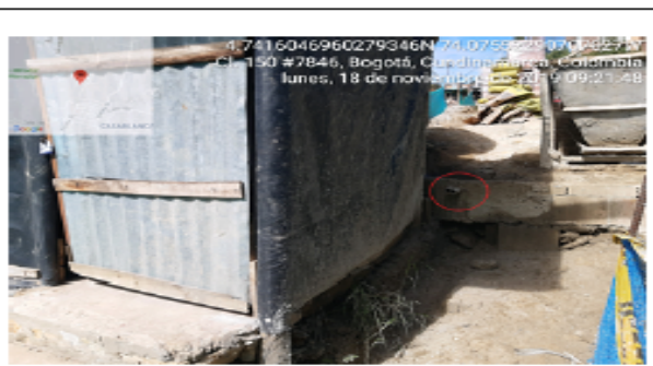
Fotografía 4. Tubería por donde se evacua la mezcla de cemento al suelo blando. Fuente: SCASP Grupo RCD – noviembre 2019.
