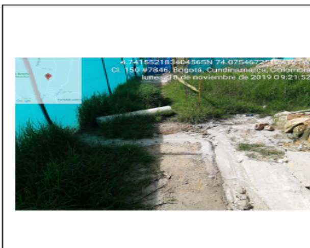
Fotografía 5. Afectación del suelo derrame de la mezcla de cemento. Fuente: SCASP Grupo RCD – noviembre, 2019
